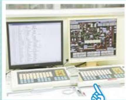
タンク内の量・温度や洗浄などは制御室でシステム管理
